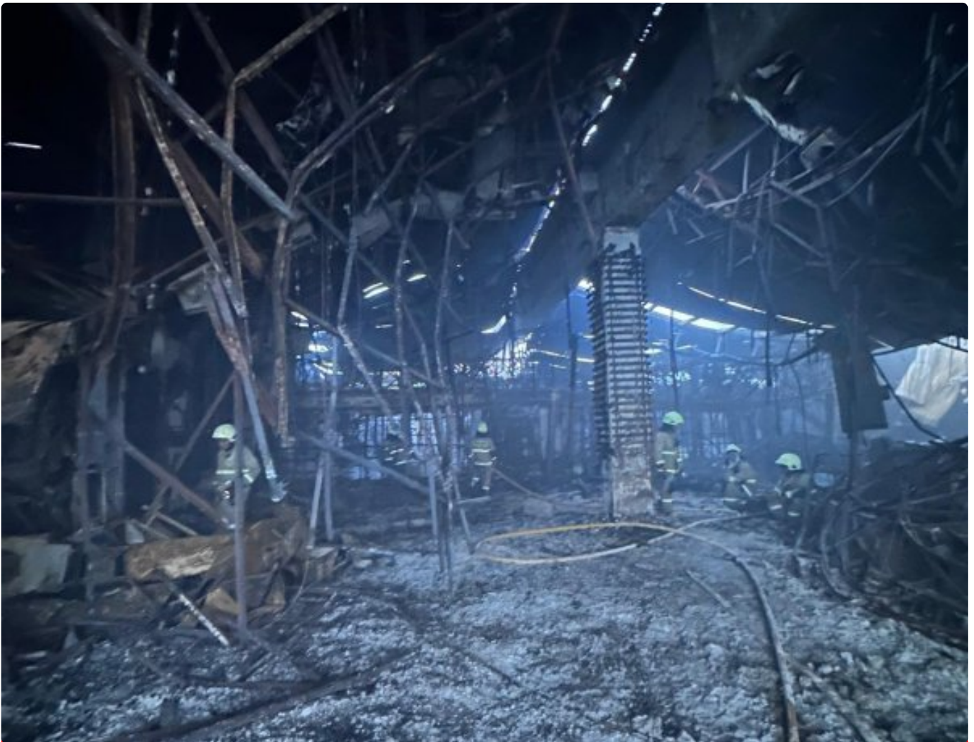
Glodok Plaza yang Hangus Terbakar
